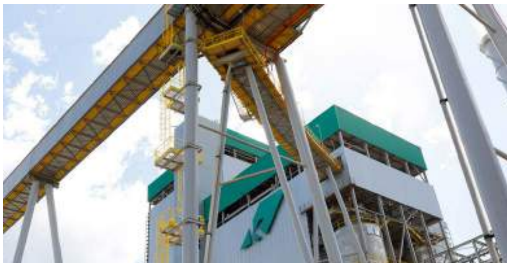
Caldeira de biomassa da Unidade Puma. Foto: Klabin.
